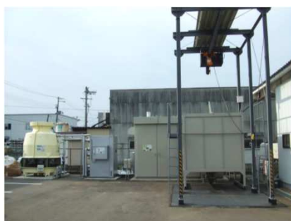
木質チップボイラーシステム外観
