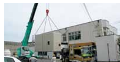
パッケージ筐体ごとトラックで搬送・設置が可能
