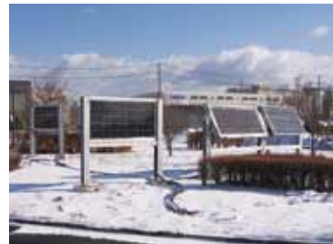
太陽電池パネル
