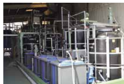
リン回収プラント
