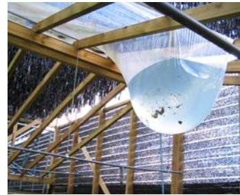
写真-4 雨水が溜まって膨らんだ雨除け資材 凍結・融解を繰り返して重くなり破損する
