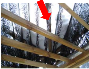
写真-1 天井付近に付着した残雪
