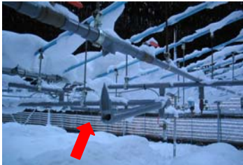
写真-2 雨除け資材用のパイプに着雪した雪 中央は落雪により折れた給水管
