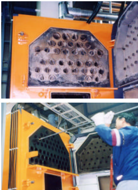
写真2 ススにより汚れた熱交換部(上)とその掃除の状況(下)
