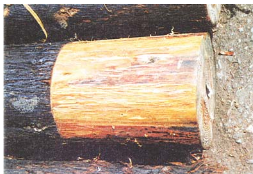
剥皮後の変色の状況
