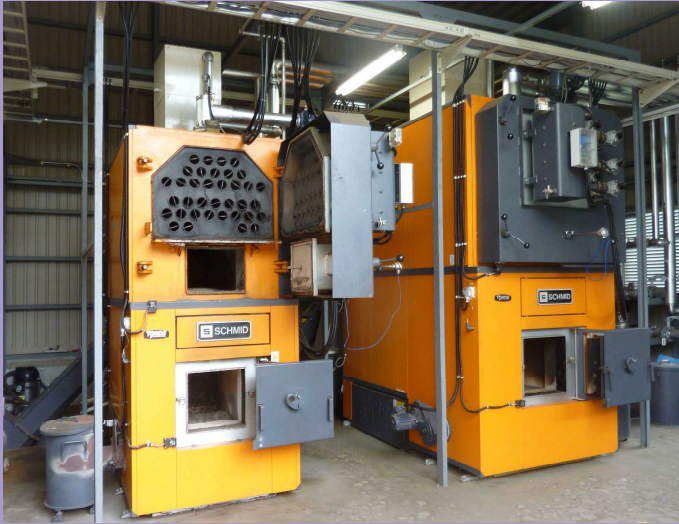
林業技術センターのチップボイラー
