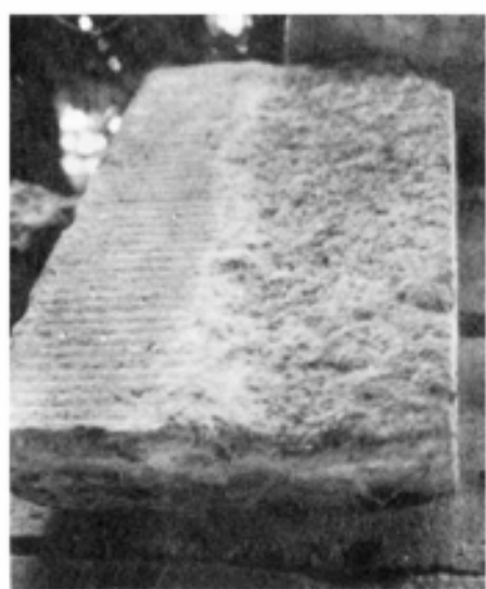
写真-9 解体した窯口付近の石の損傷状況
