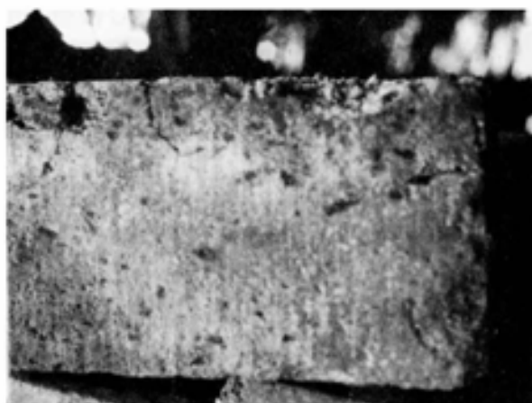
写真-10 解体した窯壁の石の損傷状況
