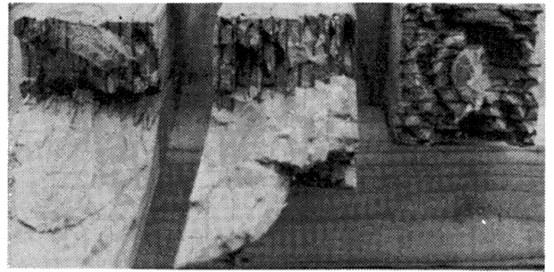
写真-4 曲げ破壊後のジョイント部
