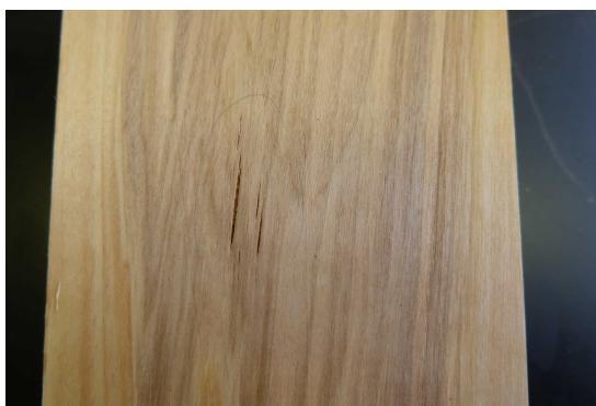
写真4 シラカバの初期割れ（材面割れ）
