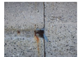
防潮堤の亀裂
