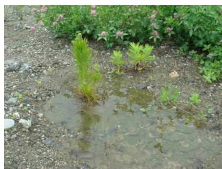
植栽基盤上で発生した滞水
