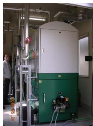
写真 木質バイオマスエネルギー導入事例（花巻市立大迫保育園のいわて型チップボイラー）
