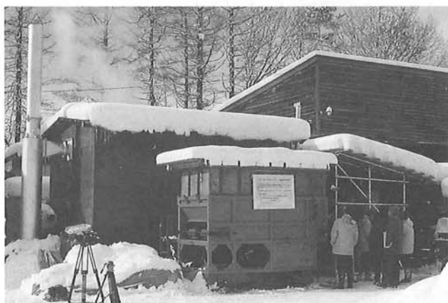
いわて型小型蒸気ボイラーの全景説明会
