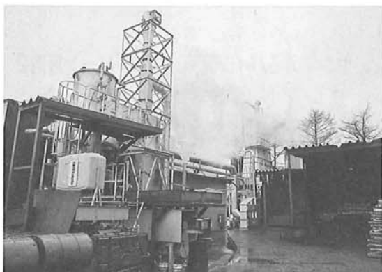
H17に導入した木屑焚きボイラー
