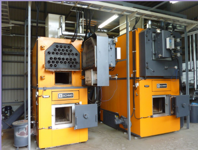
林業技術センターのチップボイラー
